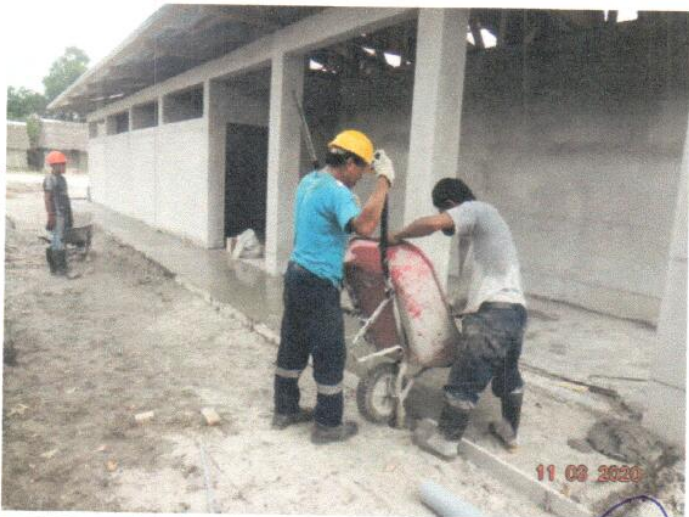
VACEO VEREDA DE MORTERO F'C= 175 KG/CM 2 , E=4" – EN LADO POSTERIOR MODULO ADMINISTRACIÓN PRIMARIA
