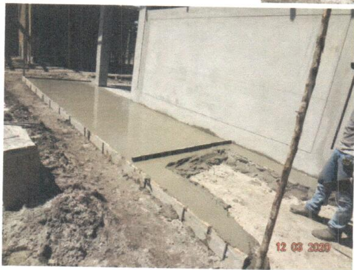
VACEO VEREDA DE MORTERO F'C= 175 KG/CM 2 , E=4" – EN LADO LATERAL MODULO ADMINISTRACIÓN PRIMARIA
